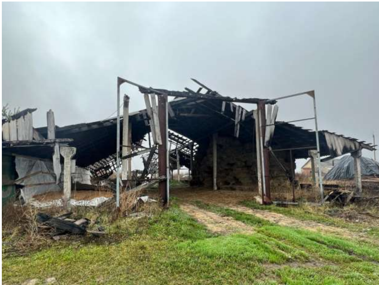
Зруйновані виробничі будівлі фермерського господарства «Світанок». Село Почепин, Макарівська селищна громада Бучанського району Київської області. 16.11.2022. @ Державна установа "Інститут економіки та прогнозування НАН України".
